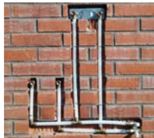
Instalación Sanitaria Tradicional
